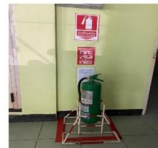
5.5.3 (รูป 1) การติดตั้งอุปกรณ์ให้แจ้งเหตุ อาคาร 39
